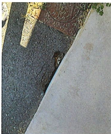
Chaussée dégradée Réfection cours terme
