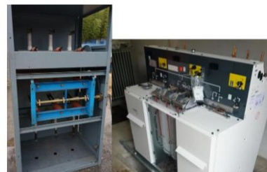
Ancien élément de la cellule Haute Tension et nouvel équipement
